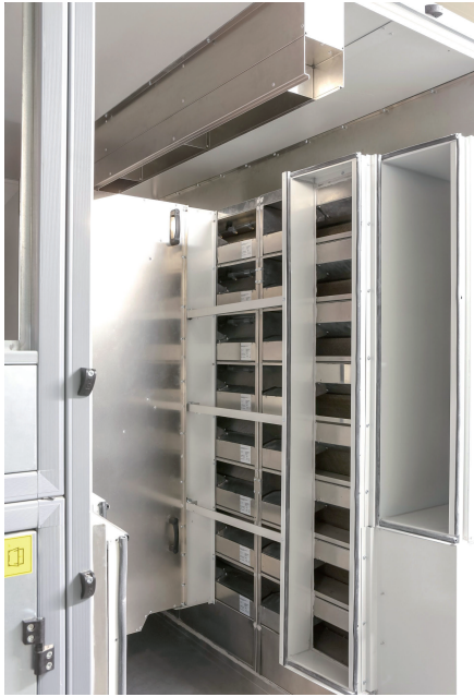
Bild 5 Ka 2 O -Module in einem RLT-Gerät
